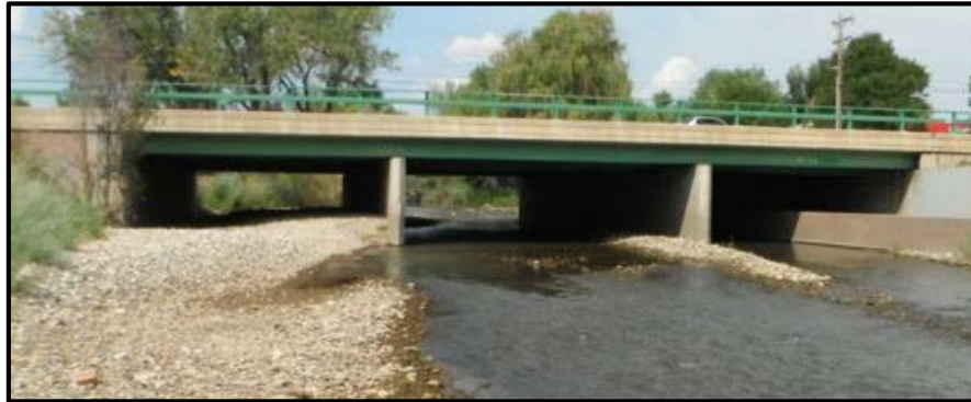
شکل ۳-۴۶- گرفتگی یکی از دهانه‌های پل توسط رسوب
