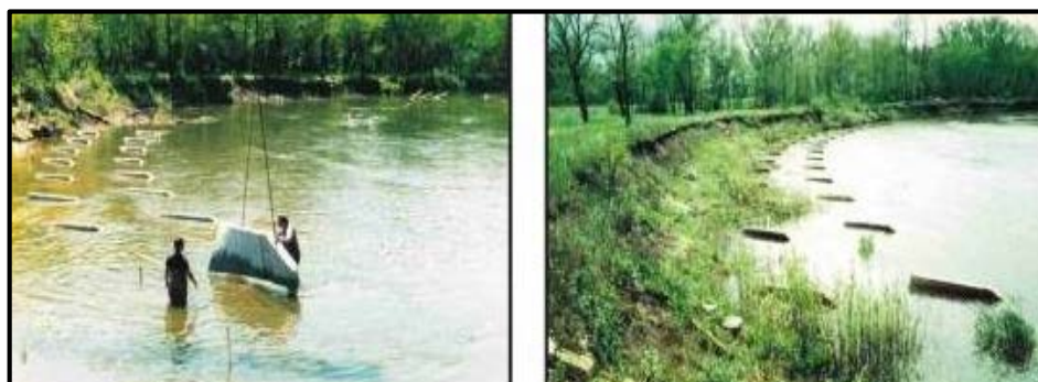
شکل پ. ۴-۲۲- صفحات مستغرق بتنی در حفاظت پیچ رودخانه در بازه‌ی پل
